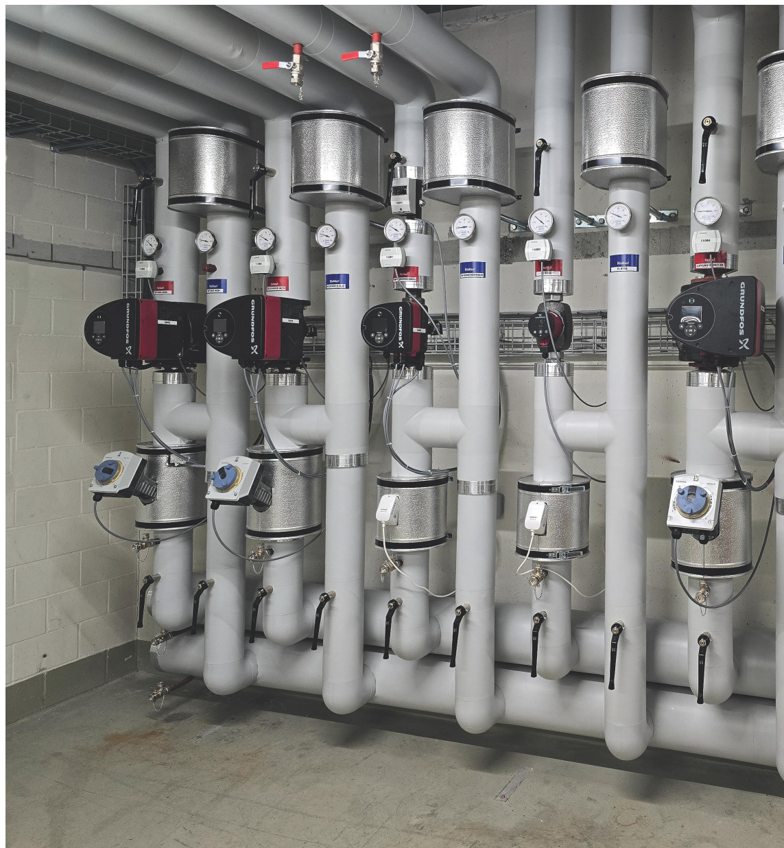
Die neue Heizungsunterstation für die Mehrzweckhalle und das Gemeindehaus
