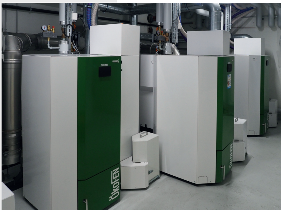
Die Holzpelletsheizung für die Schul- und Gemeindeanlagen Jonen, deren Anschaffung im Jahr 2020 mit Förderbeiträgen aus der Forstreserve unterstützt worden ist.
